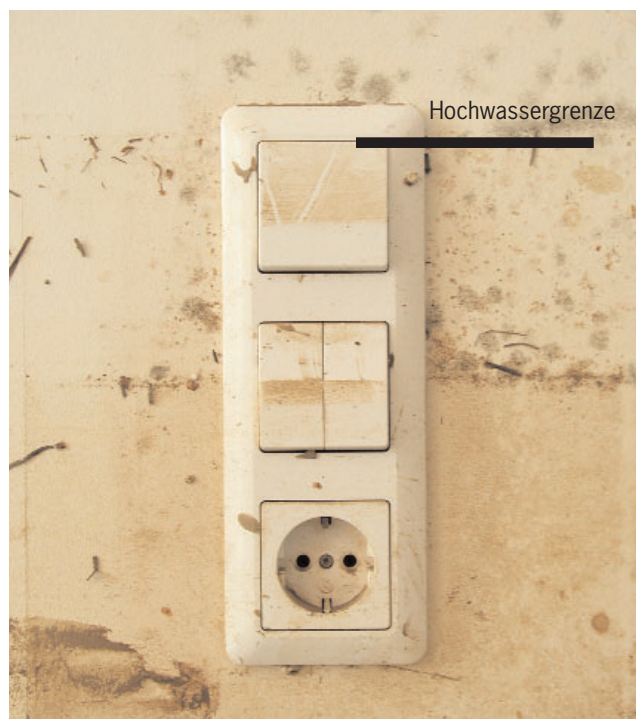
Die Hochwasserlinie ist am Lichtschalter gut erkennbar
