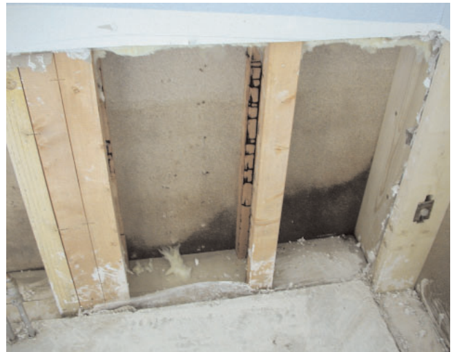
Die Fußschwelle ist ein sensibler Bereich für Feuchtenester, die Konstruktion sollte von Verunreinigungen befreit werden
