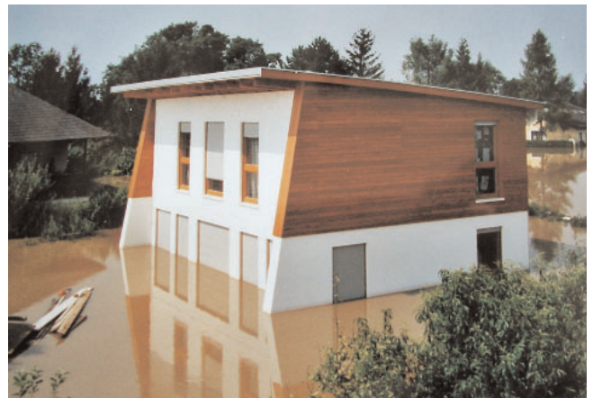
Infolge des Hochwassers steht dieses Holz-Fertighaus bis zum halben Erdgeschoss komplett im Wasser
