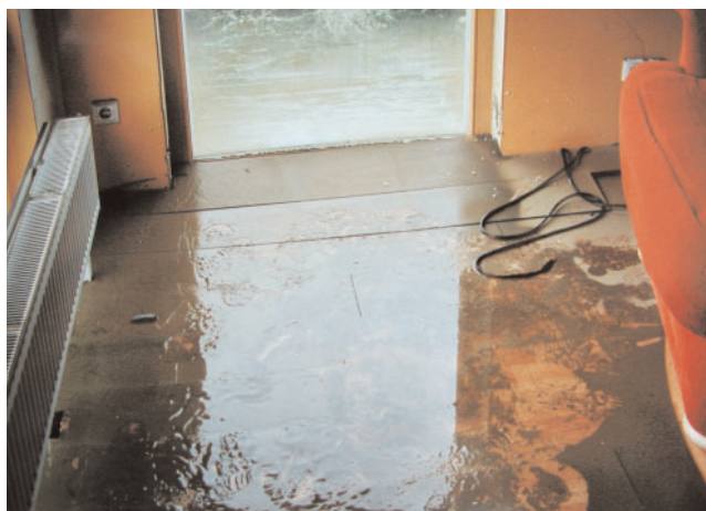
Nach dem Abfließen des Wassers bleiben auch Schlammreste zurück. Zum Austrocknen muss der komplette Fußboden geöffnet werden
